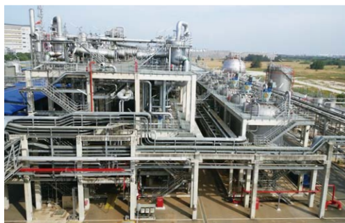
S-SBR 製造プラント (ゼオンケミカルズシンガポール社第二プラント)
